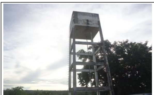
FOTO Nº 03 - FONTE DE ÁGUA 01 (FONTE DE ÁGUA 02 DO TRECHO 02 - E159+15,00 - Dist. Fixa = 505m
